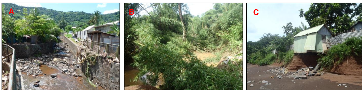
Figure 11 – Impacts du cyclone Hellen, mars 2014. A : Laises de crues sur le garde-corps du canal dans le centre-ville d'Acoua ; B : Embacles formés par les bambous dans le lit de la rivière en amont du pont de Dzoumogné ; C : Affouillement sous une habitation en tôle (village de Nyambo- Bandraboua).
