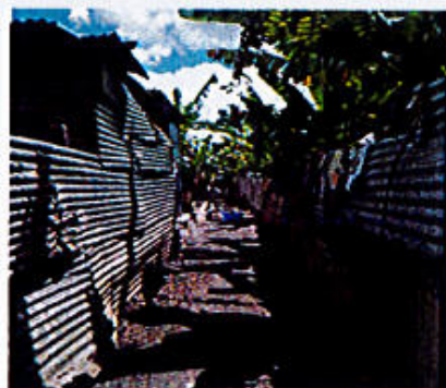
Poto 5 : Toit et Mur non jointifs
