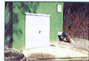
Photo 8 : Seuil de Bouyouni Bas, Juin 2003. Station de pompage. BRGM Mayotte
