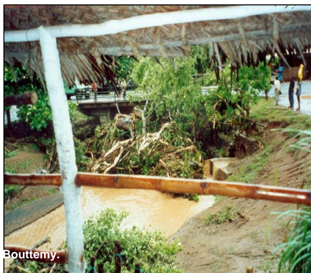
Embâcle de branchages sous le pont de Bandrélé, le 7 mars 2001.
