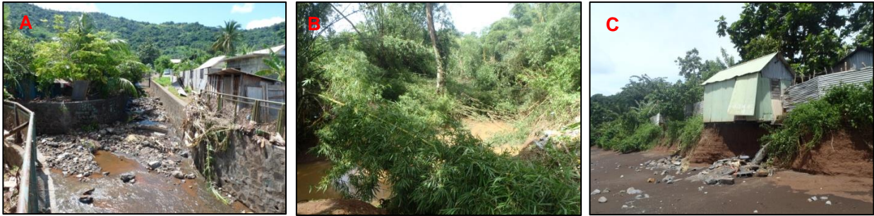
Figure 11 – Impacts du cyclone Hellen, mars 2014. A : Laisse de crues sur le garde-corps du canal dans le centre-ville d'Acoua ; B : Embacles formés par les bambous dans le lit de la rivière en amont du pont de Dzoumogné ; C : Affouillement sous une habitation en tôle (village de Nyambo- Bandraboua).
