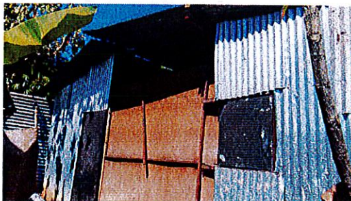
Photo 5 : absence de jointure, d'étanchéité
