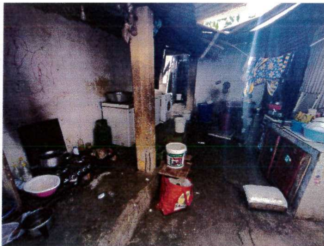
Photo n°19 : plusieurs coins cuisines aménagés en extérieur, bidons usagés pour le stockage d'eau, plusieurs bonbonnes de gaz, plafond en ruine.
