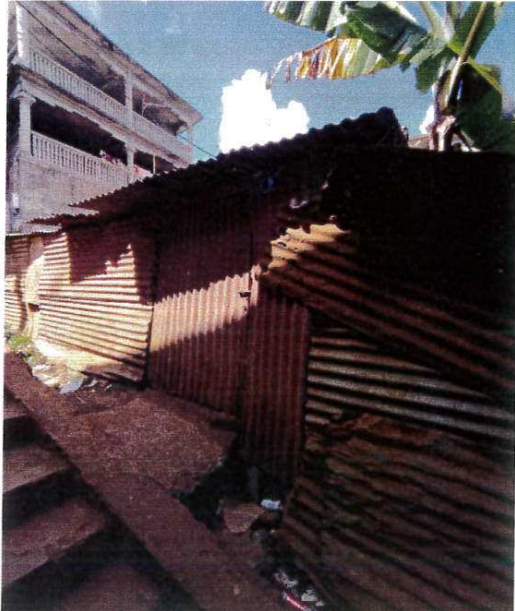
Photo n°5 : construction dépourvue de fondations, tôle clouée sur structure en bois, manque d'éclairage naturel.
