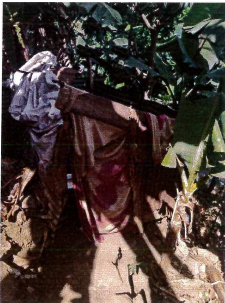
Photo n°15 : exemple de local sanitaire formée par assemblage de matériaux hétéroclites en très mauvais état, absence de toiture.
