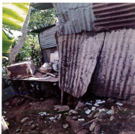
Photo n°3 : érosion, sols non plans, risques de chute et blessures, présence de débris.
