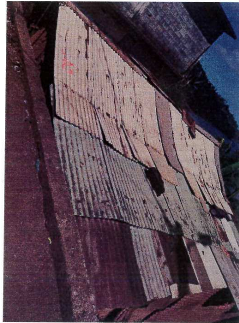
Photo n°6 : construction dépourvue de fondations, toit en tôle avec parpaings poser dessus, risque d'accidents (chute d'éléments).
