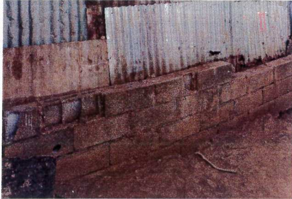
Photo n°9 : mur projeté sur l'embase d'une construction, absence d'étanchéité.
