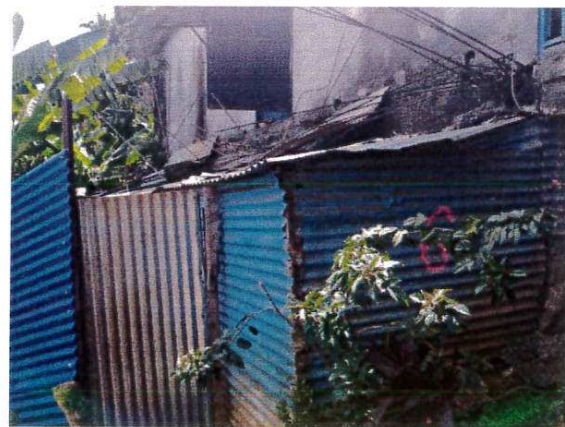
Photo n°12 : Construction n° 6 rez-de-chaussée assemblage de morceaux de tôle ondulée rouillée, suspicion de marchand de sommeil.
