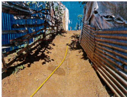
Photo n°12 : tuyau d'eau d'origine inconnue
