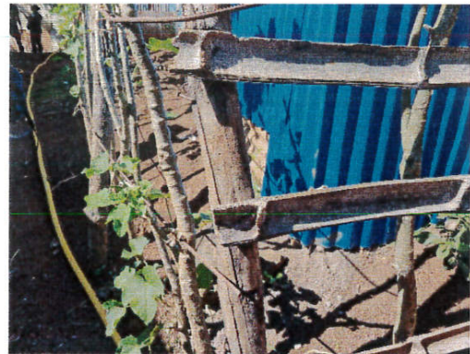
Photo n°10 : tuyau d'eau d'origine inconnue
