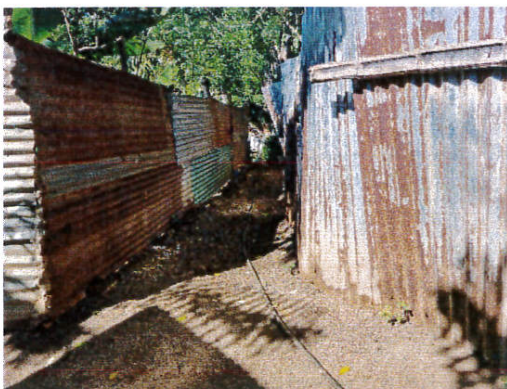
Photo n°11 : tuyau d'eau d'origine inconnue
