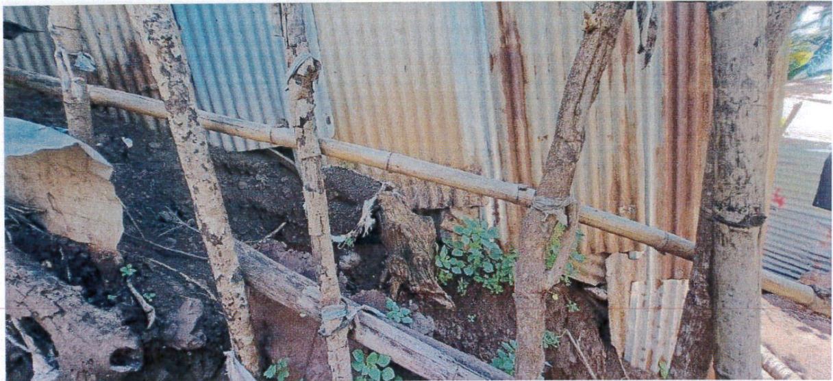
Photo n°10 : Construction sans fondations aménagée dans une pente
