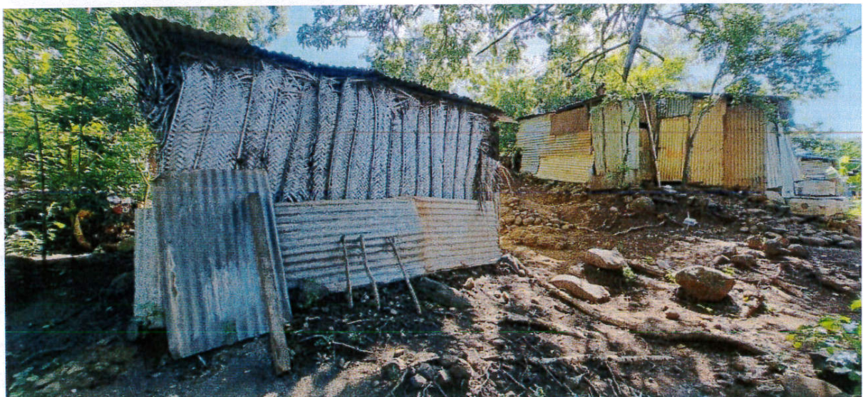
Photo n°11 : Constructions en matériaux hétéroclites mal assemblés
