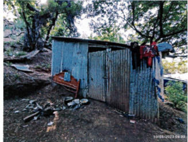
Photo n°6 : construction dépourvue de fondations, tôle clouée sur structure en bois, manque d'éclairage naturel dans la pièce de vie
