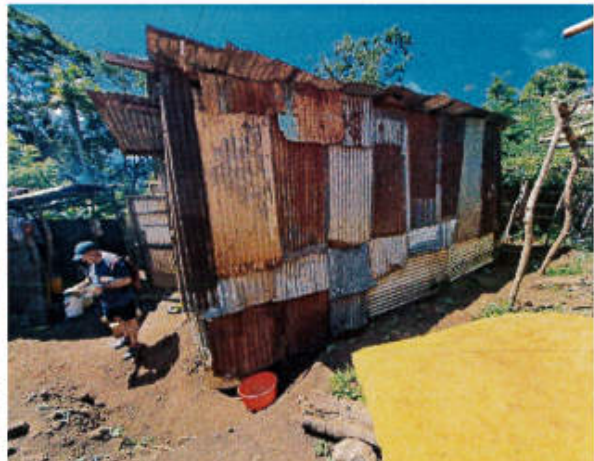
Photo n°12 : assemblage de morceaux de tôle ondulée rouillée, absence d'ouvertures donnant sur l'extérieur
