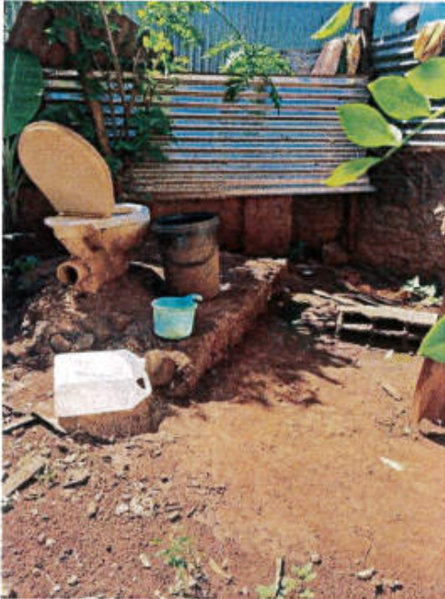
Photo 21 : équipement sanitaire rudimentaire, absence d'installation d'assainissement
