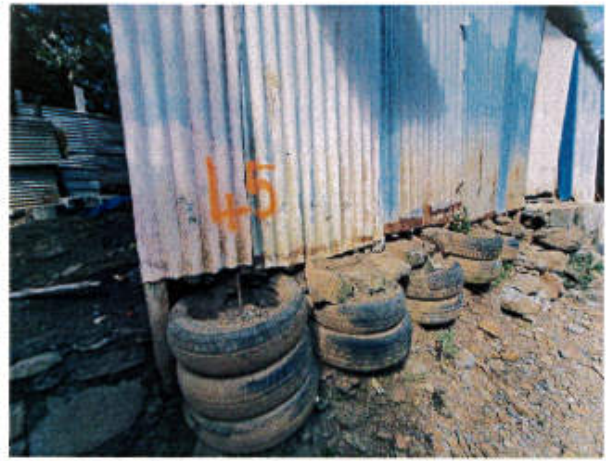
Photo n°8 : absence de fondations, pneus soutenant la construction
