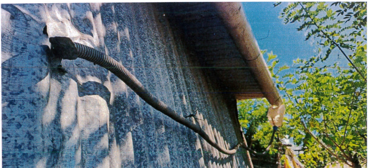
Photo n°5 : Installation de récupération d'eau pluviale, réutilisation à l'intérieur du local
