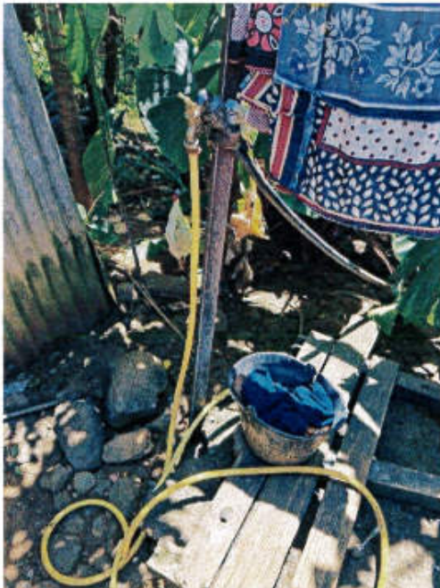
Photo n°27 : robinet d'eau à proximité du local n°34
