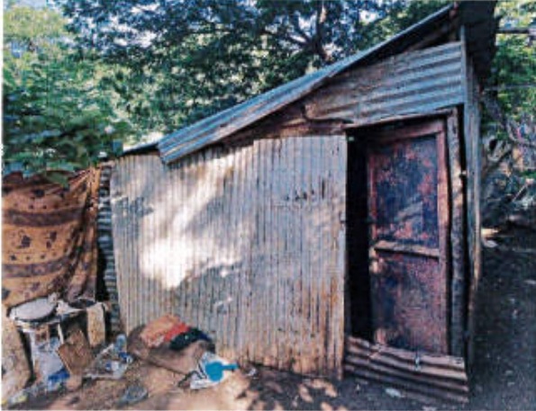
Photo n°5 : construction dépourvue de fondations, tôle clouée sur structure en bois, manque d'éclairage naturel dans la pièce de vie
