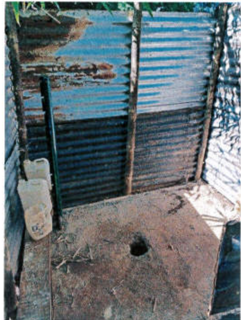
Photo n°22 : équipement sanitaire rudimentaire, absence d'installation d'assainissement
