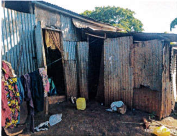
Photo n°7 : assemblage de tôles dégradées, non jointives
