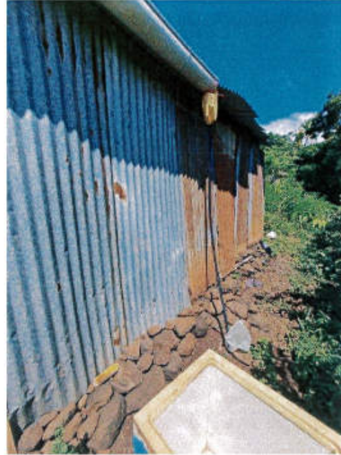
Photo n°26 : installation sommaire de récupération d'eau pluviale
