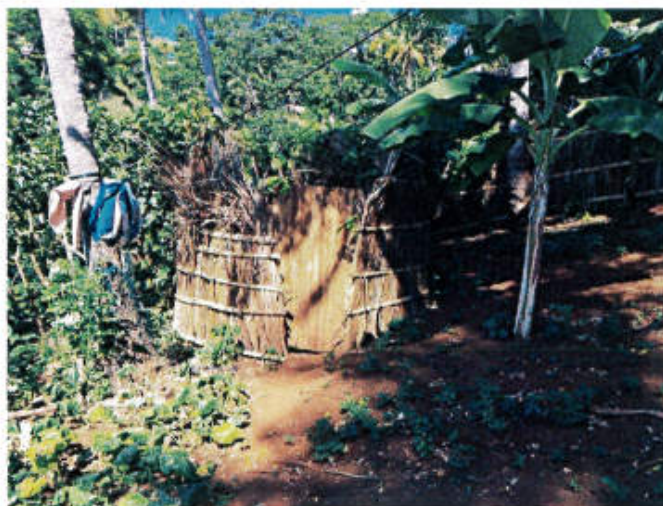
Photo n°19 : exemple de local sanitaire, absence de toiture
